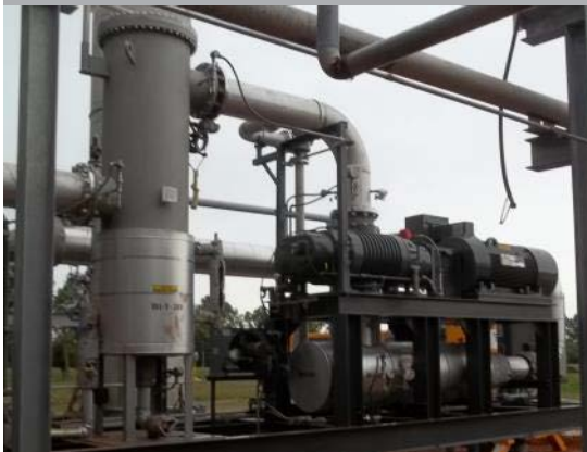
Landfill gas inlet
